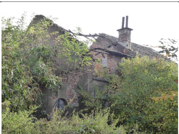
La ferme du Meylemeersch – laissée en ruine
